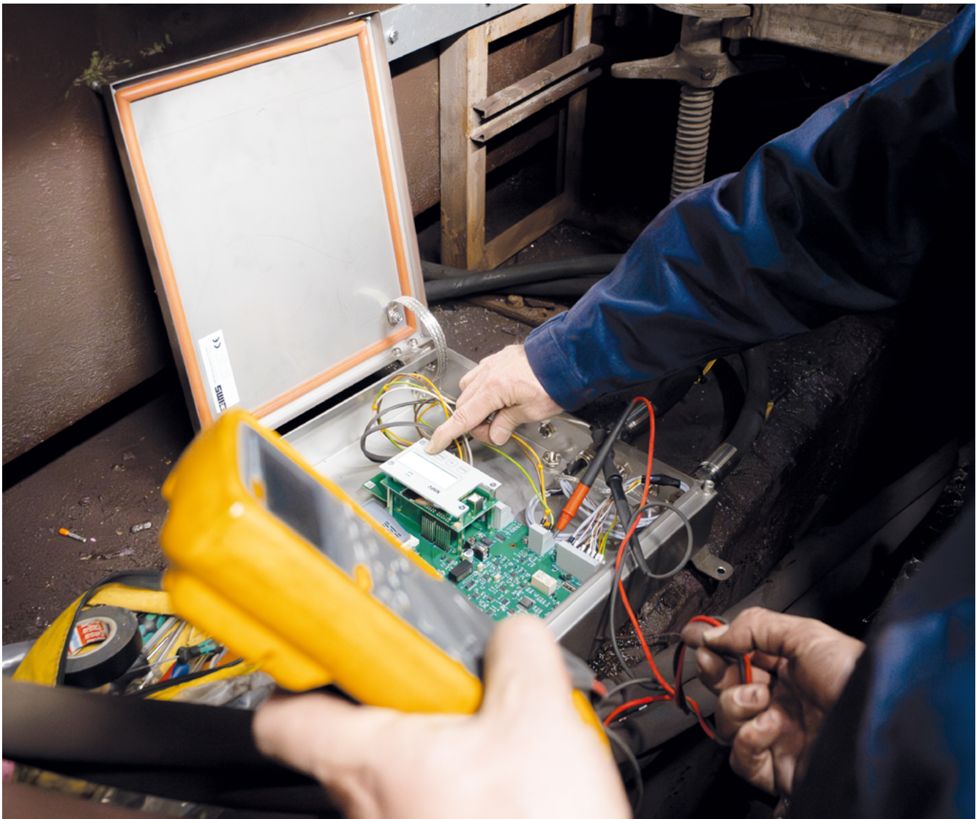
Abbildung 3: Installation eines EdgerKraft Controllers (MMV) in einem Warmwalzwerk
