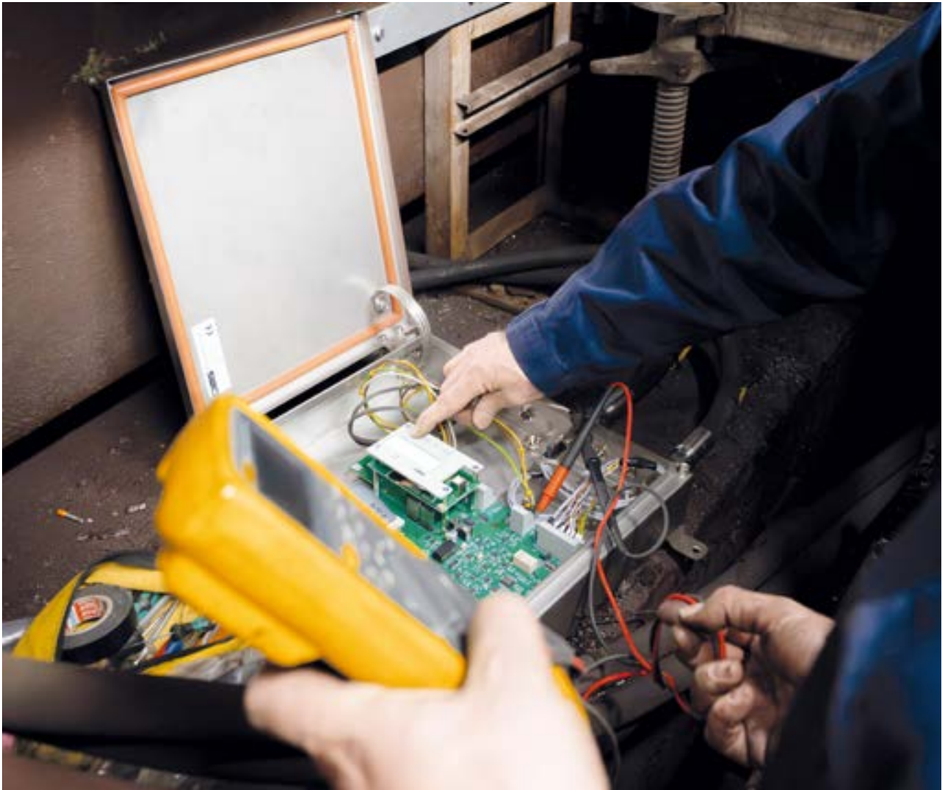
Abbildung 3: Installation eines RollKraft Controllers (MMV) in einem Warmwalzwerk.
