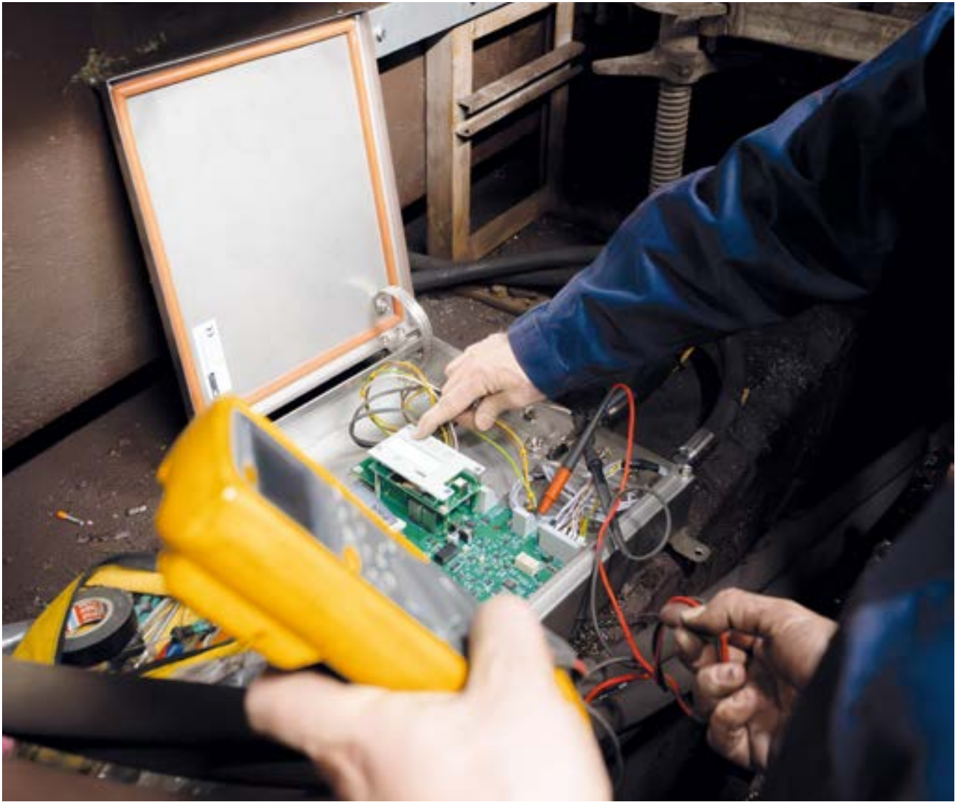
Abbildung 3: Installation eines StripKraft Controllers (MMV) in einem Warmwalzwerk
